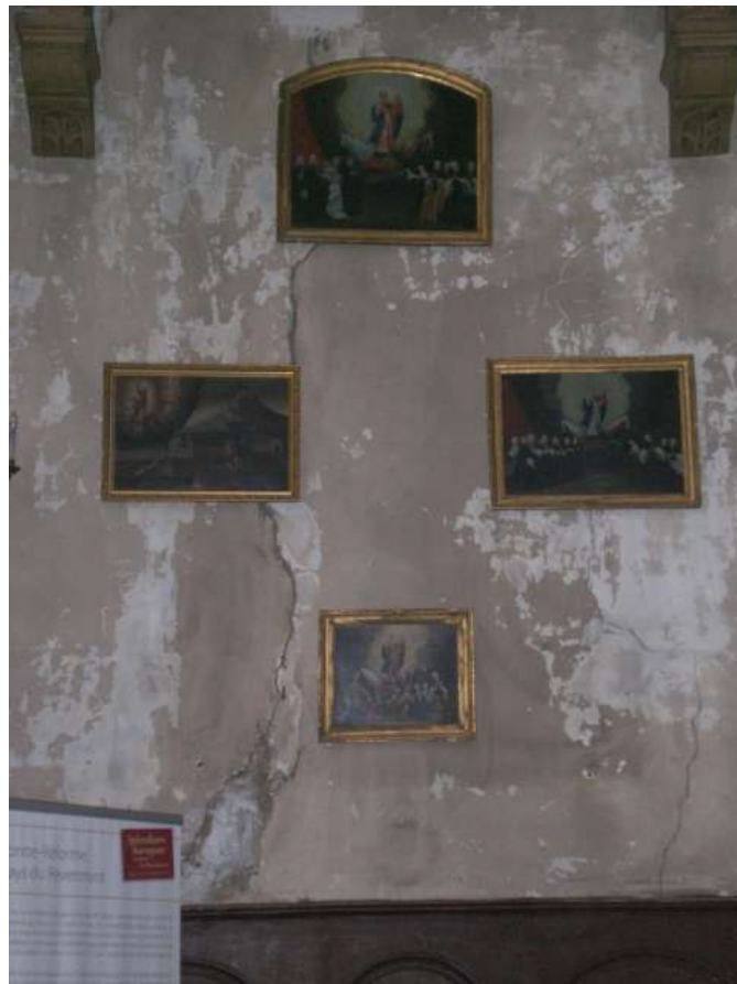
Fissure dans le mur Nord
