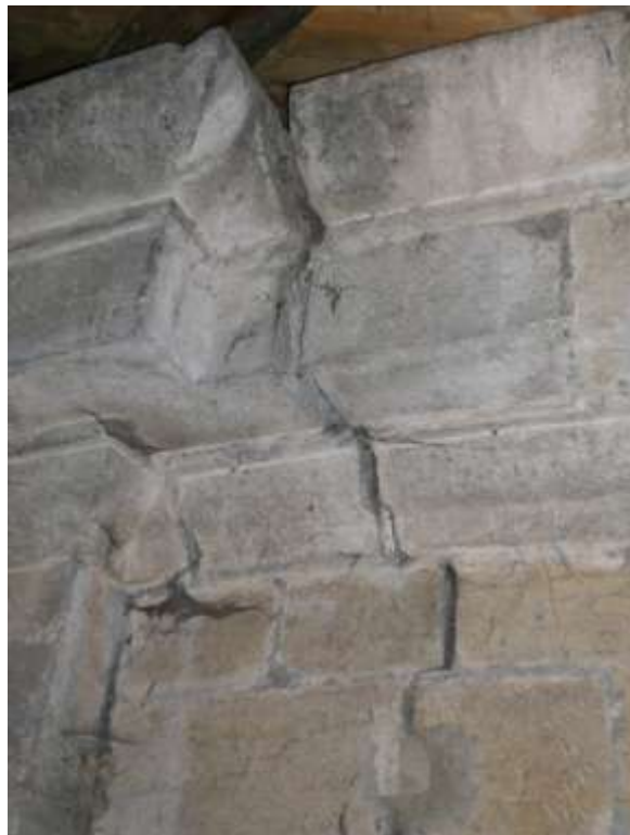
Fissure dans le haut du mur sud-est (grenier du porche)
