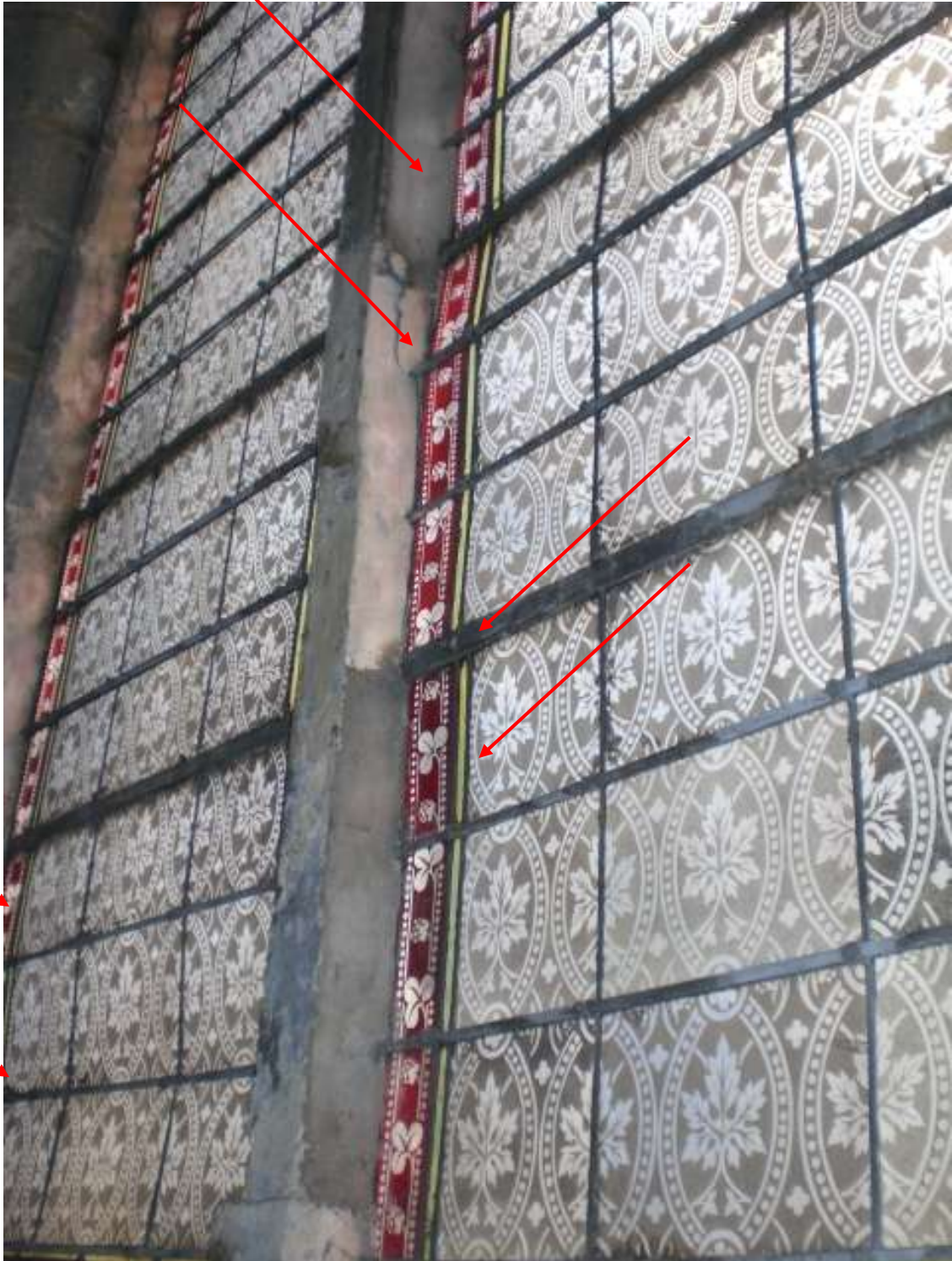
Déformation du vitrail Sud-Est
