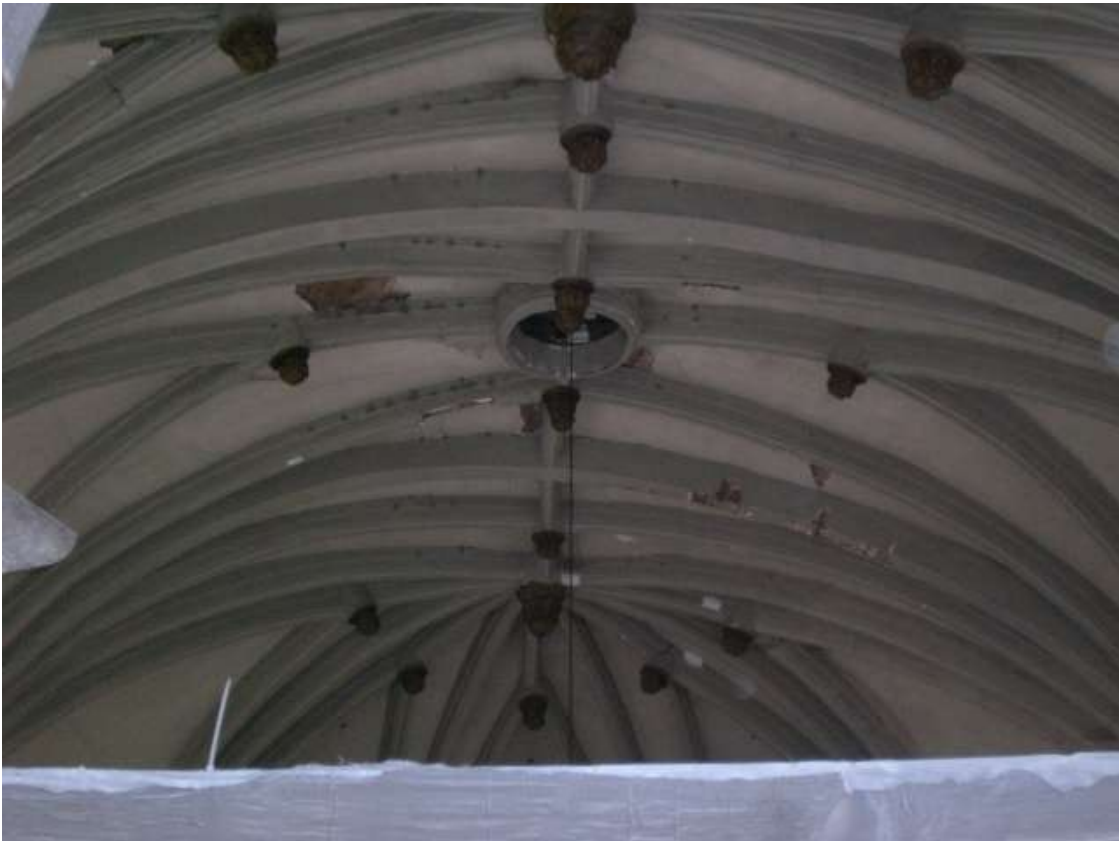
Chutes de plâtre de la voûte sur structure bois de la nef (protection par un filet)
